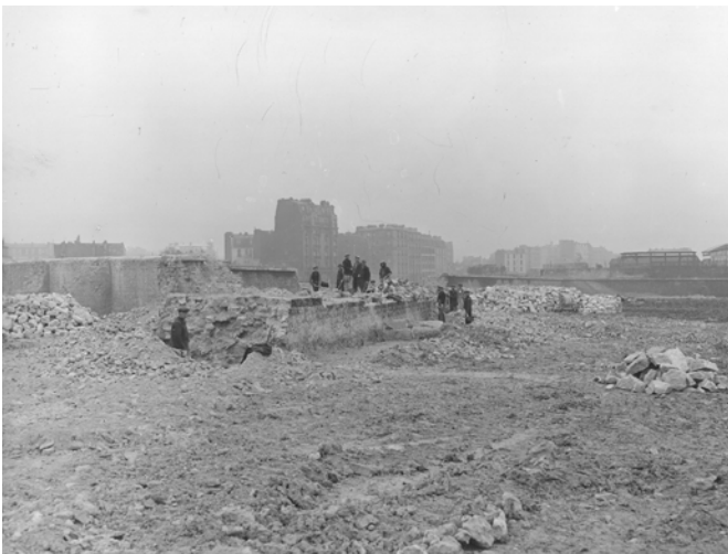
La démolition de l'enceinte de Thiers, chantier du dérasement du bastion 47, au niveau de la porte Pouchet, 1932. Photographie de LEM. Épreuve argentique. Archives de Paris. Crédit: © LEM / Archives de Paris.
